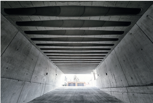
Abbildung 8: Untersicht Decke über Tiefgaragenabfahrt (Nördlingen, Deutschland); © Studio Herzig/EIGNER Bauunternehmung
