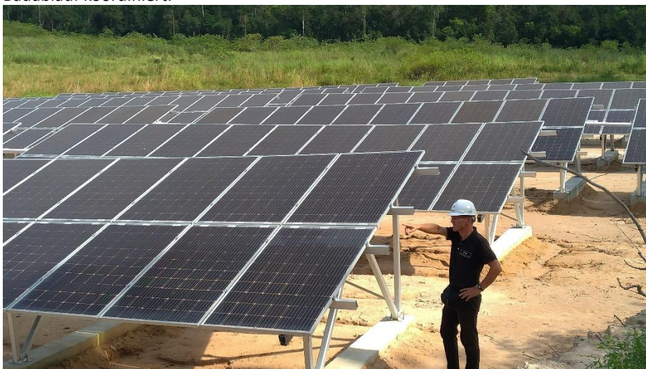
Abbildung 4 Projektmanager Torsten Schubert begutachtet die neu errichtete PV-Anlage. © 2020 Ortner Energy Group
