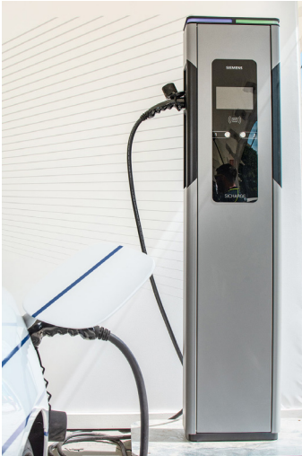
Ein großer Teil der Ladestellen im Microgrid wird gemessen und gesteuert. Das generiert u.a. Daten zum Ladeverhalten der Fahrzeuge.
