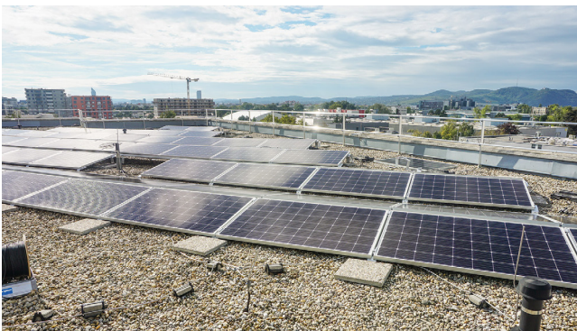
Ein Teil der insgesamt 1600 m 2 umfassenden Photovoltaikanlage mit einer Spitzenleistung von 312 kW.
