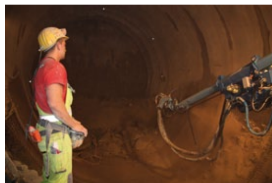
Anwendung der New Austrian Tunneling Method (NATM) im Rahmen der Vortriebsarbeiten am Koralmtunnel
